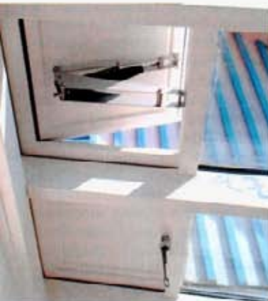
Im Hintergrund eine manuell zu öffnende Lüftungsklappe. Vorne sichtbar ein thermisch gesteuerter Dachklappenöffner
